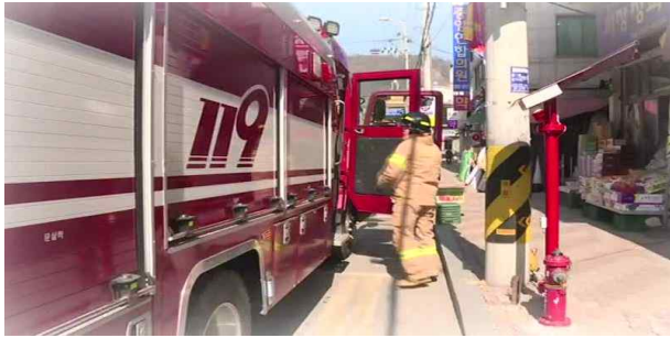
< 지능형소화전 설치사진(경북 예천) >
