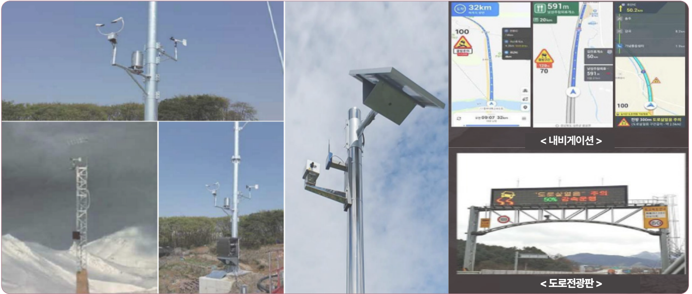
▲고속도로 CCTV 지지대에 설치된 각종 센서를 통해 분석한 도로 위험 기상 정보(도로 살얼음 주의)를 운전자에게 제공하고 있다.
