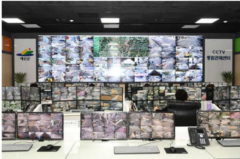
[그림 2.38] 예산군 CCTV통합관제센터
