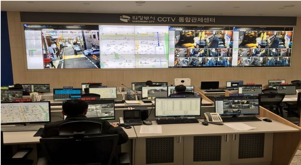
[그림 II-4-29] 의정부시 CCTV 통합관제센터
